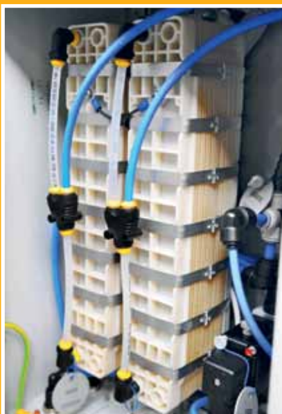
Herzstück der Anlage: die Elektrodeionisierung
