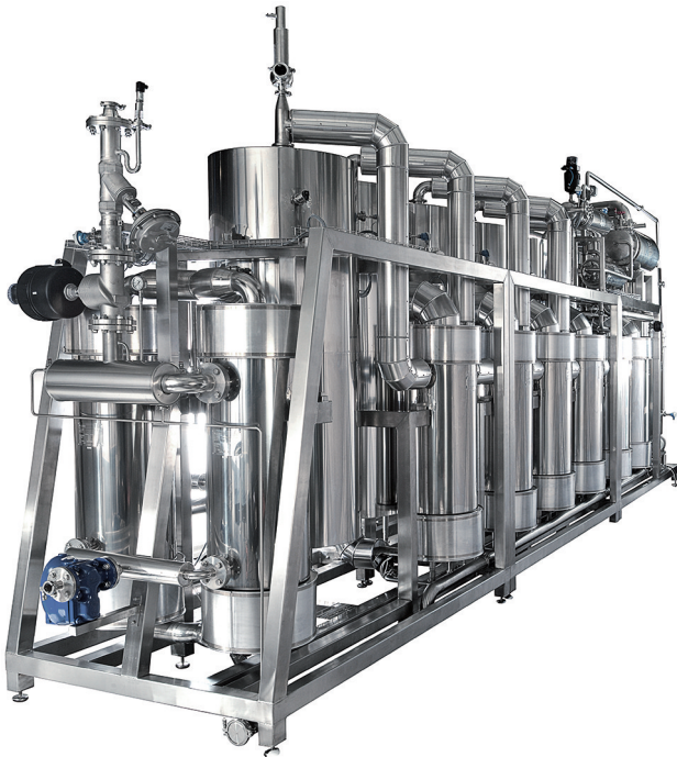
Abbildung 6: Destillation zur WFI-Erzeugung mit kompletter Isolierung.
