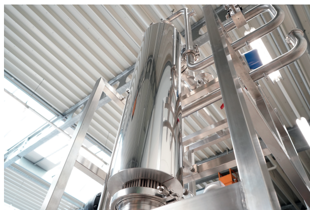
Abbildung 2: Hygienisch konstruiertes WFI-Verteilskid.
